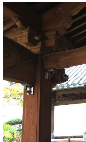
向拝の耐震リング
