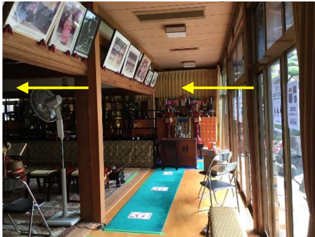
改修前の状況-と通り柱（約1/40の傾き）
